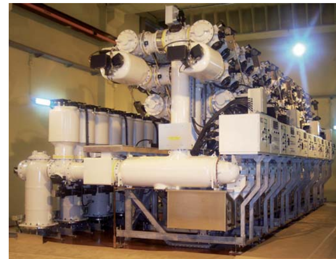
Equips de transformació.
